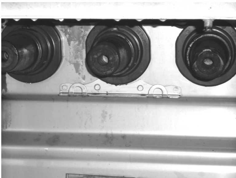
图 5-3 户外环网柜电缆导管上挂满水珠
