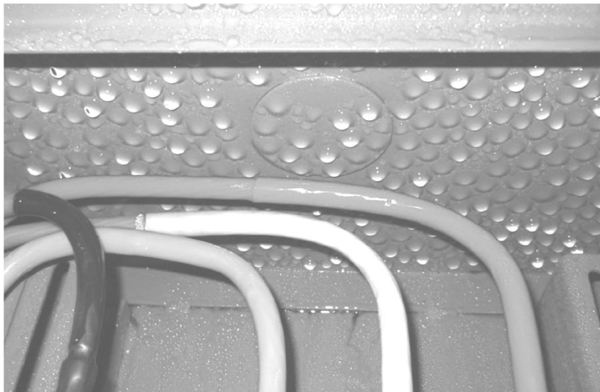
图 5-1 箱变隔室顶部挂满水珠 (另见彩图)
