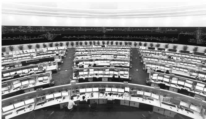
图 1.15 铁路局调度指挥中心
