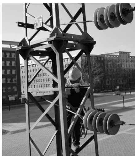
图 1.17 攀登软横跨支柱
