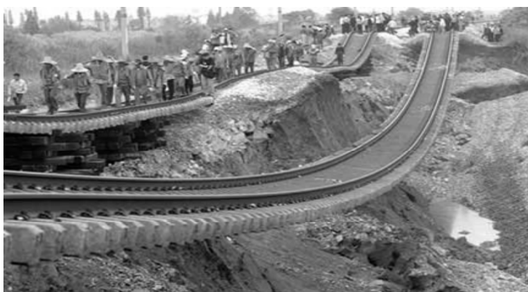
图 1-11 路基下沉事故现场
