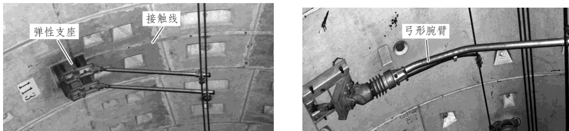
图 0-7 隧道内采用的弹性支座悬挂装置
