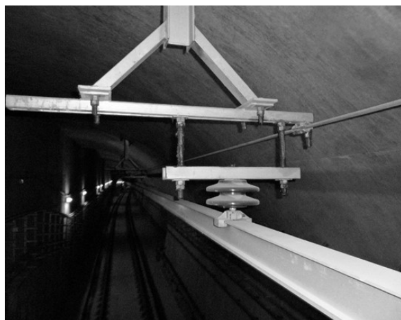
图 1-5 刚性架空接触网
