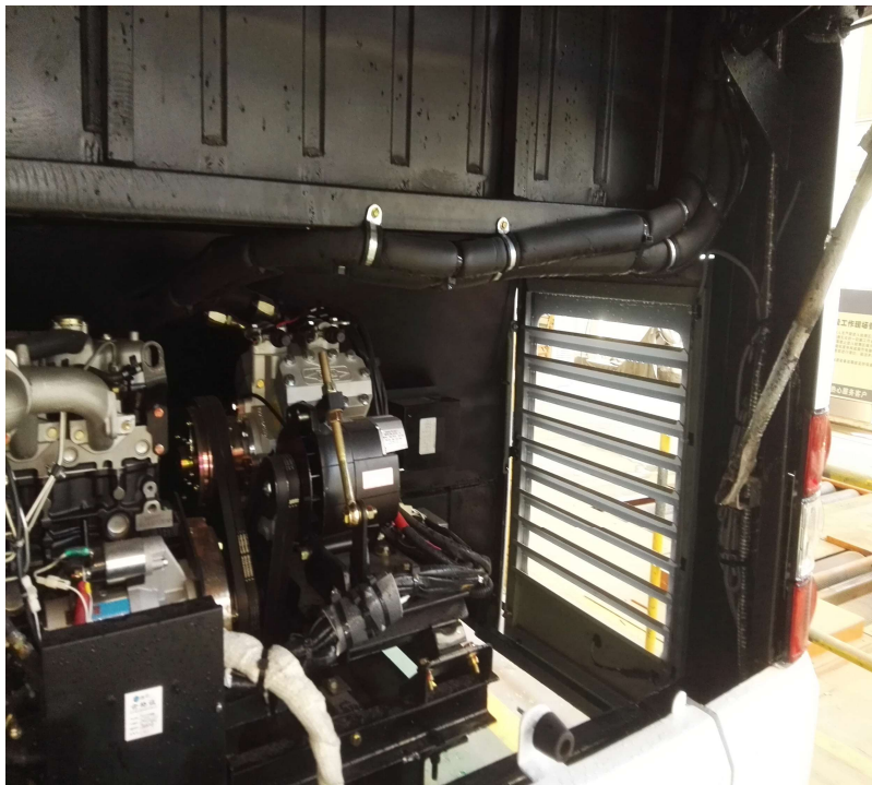
图 0-3 压缩机安装位置
