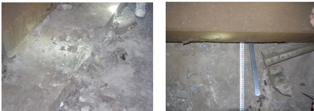
(a) 砂浆层粉化 (b) 砂浆层悬空
