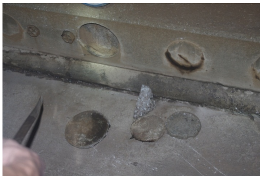
图 1-19 轨道板横向预应力钢筋封锚混凝土脱落
