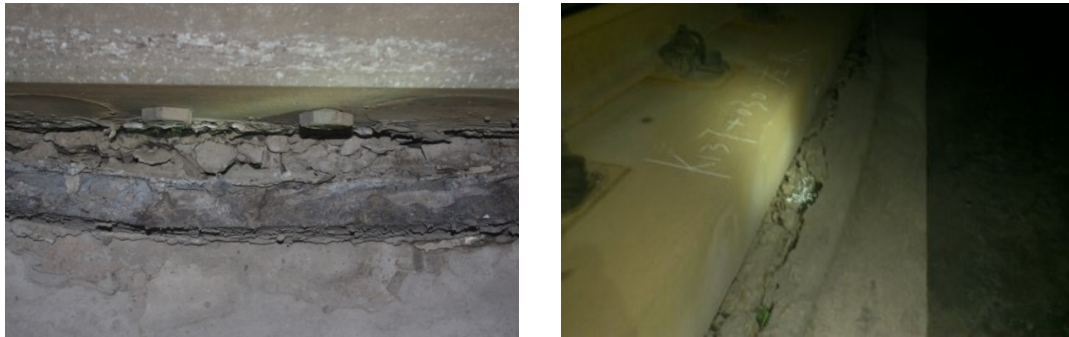
(a) 砂浆层掉块 (b) 砂浆挤出
