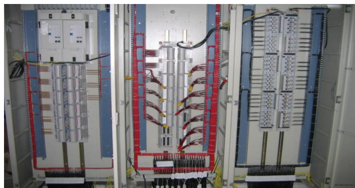
图 1-3-35 盘柜内部排线
