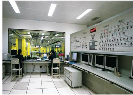
图 1-14 车站控制室实物照片
