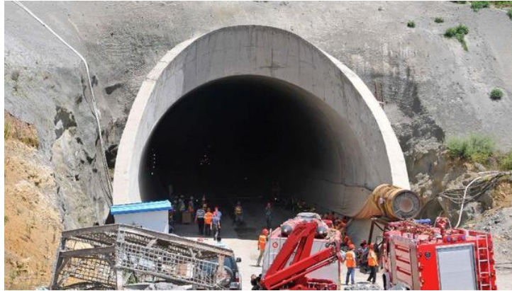
图 6-15 某铁路隧道口重大坍塌事故
