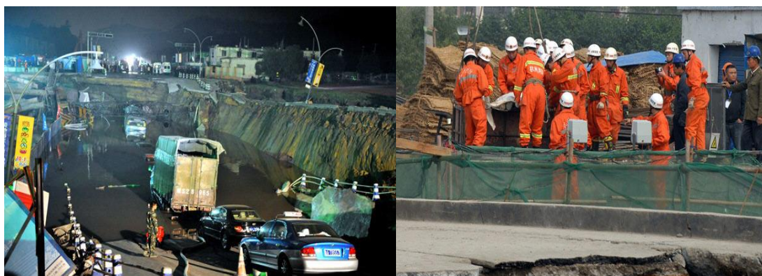
图 6-12 杭州地铁湘湖站坍塌
