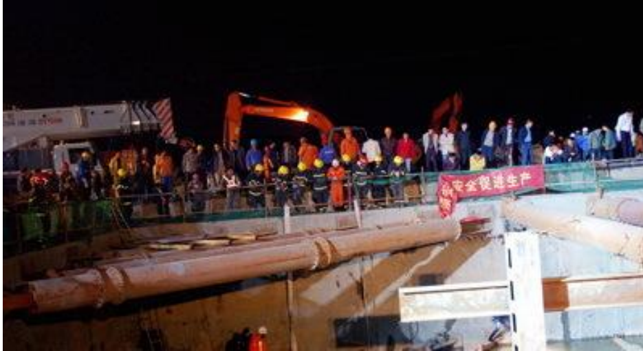
图 6-14 地下连续墙横向断裂并倒塌
