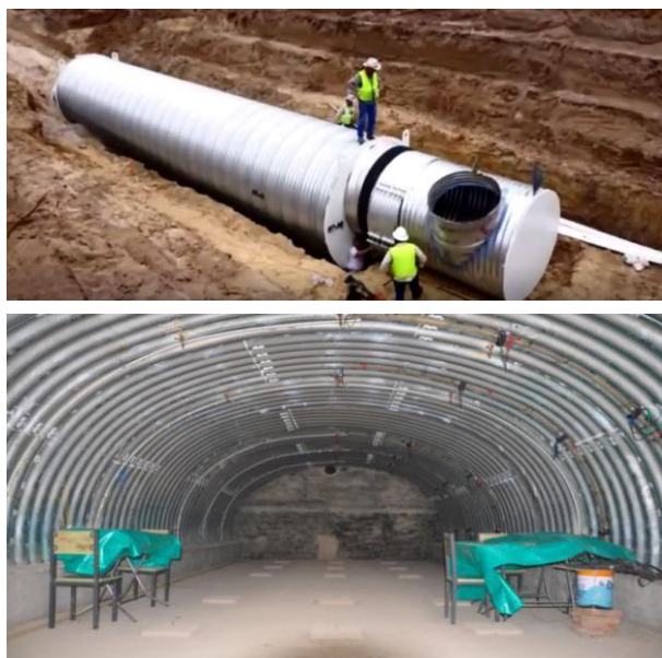
图 1.26 钢波纹板隧道避难所（战时地下救护掩体防空洞）、隧道安全屋
