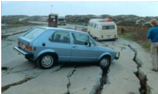
图 1-4 液化引起路面沉降
