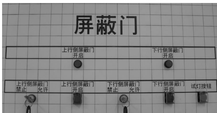
图 1-3-5 站控室屏蔽门控制盘（局部）
