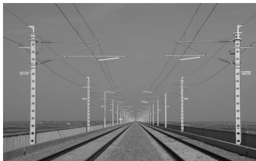
图 1.1.6 地面架空式 (柔性) 接触网
